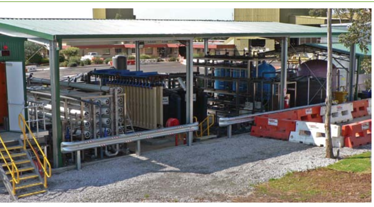
Угледобывающее предприятие в Австралии. Отводимые и сточные воды после очистки возвращаются в технологический процесс и используются в качестве питьевой воды
